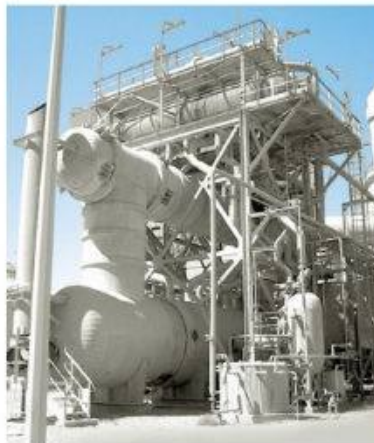
Рис. 106. Колонна синтеза аммиака
